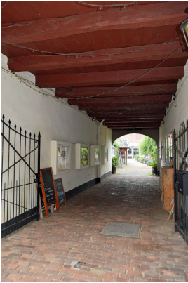
Zicht op de verdiepingsbalklaag van Meipoortstraat 39. Hoewel de vorm van de poort relatief recent tot stand is gekomen, kan de zware enkelvoudige balklaag nog goed uit de 16e- of 17e eeuw stammen.
