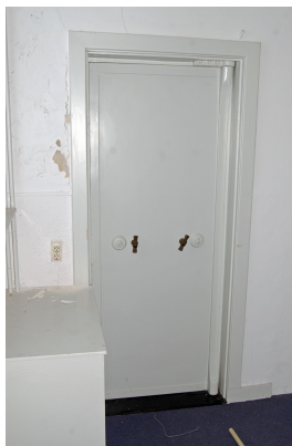
De kluisdeur die toegang geeft tot de kluisruimte.
