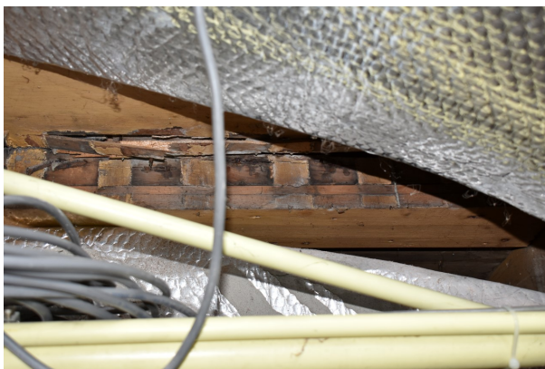
Op de vloerbalk in de voorste kelder is de ongeschilderde aftekening van het houten traliewerk zichtbaar. Dit bewijst dat zowel het traliewerk als de okergele afwerking tot de oorspronkelijke opzet behoort moet hebben.
